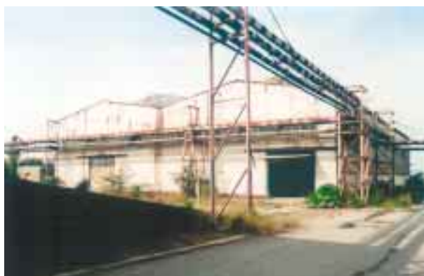
Hala č. 83 v havarijním technickém stavu
