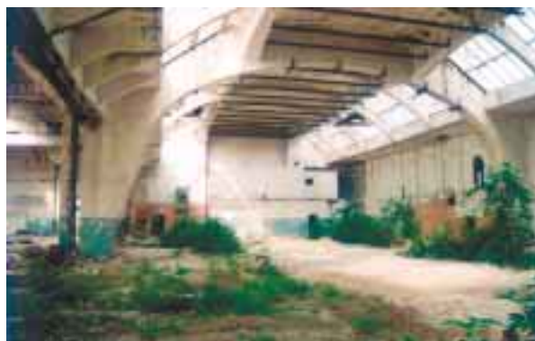
Hala č. 38 s architektonicky hodnotnou konstrukcí, avšak v havarijním stavu; zde umístěná galvanovna byla nejvýznamnějším původcem ekologických škod
